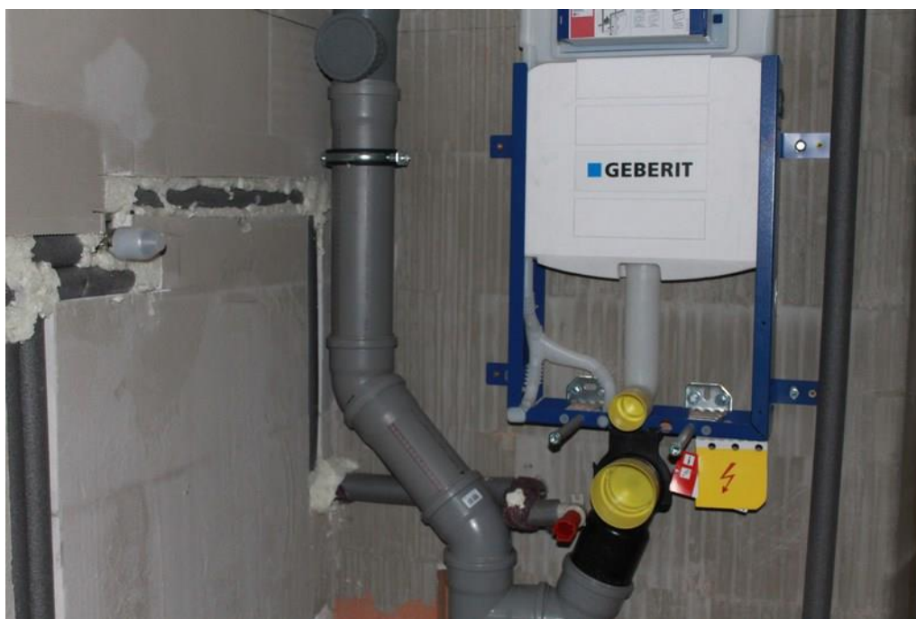
Obr. č. 25 – Zvislé odpadové potrubie
